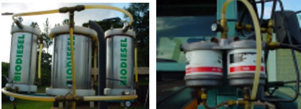
Figura 7 - Reservatórios de combustível à esquerda e filtros auxiliares à direita.
