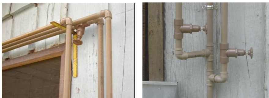
Figura 22 - Condutores de distribuição de água e registros.
