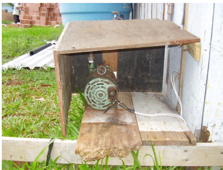
Figura 11 - Vista interna da instalação da moto-bomba hidráulica.
