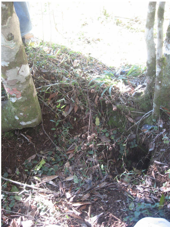
Figura 10 - Estrutura de abatimento exposta lateralmente devido à subsidência do teto do túnel.
