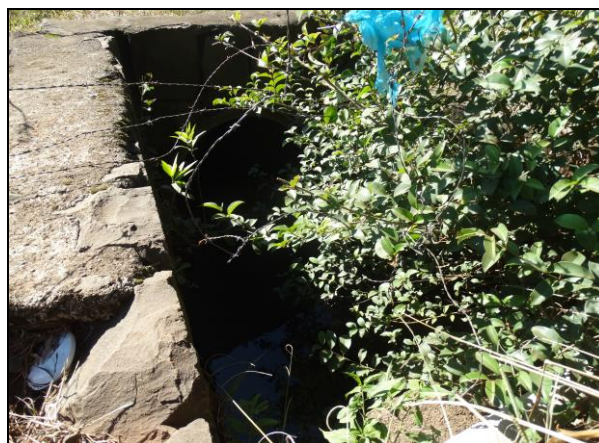
Figura 31 - Canalização do afluente do rio Urutago, sem proteção. Foto: TIBOLA, Maiara. 2015.
