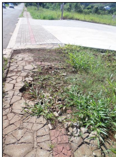
Figura 24 - Piso tátil quebrado na maior parte do percurso. Foto: TIBOLA, Maiara. 2015.
