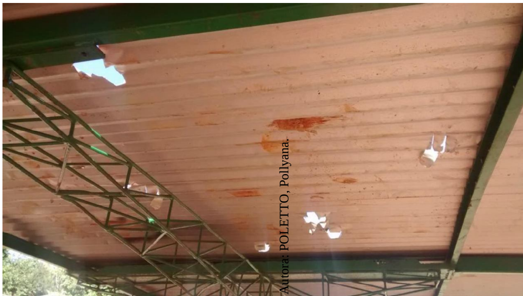
Foto 27. Cobertura precária no ponto de embarque/desembarque do bairro São João, rua Sadi Bertol
