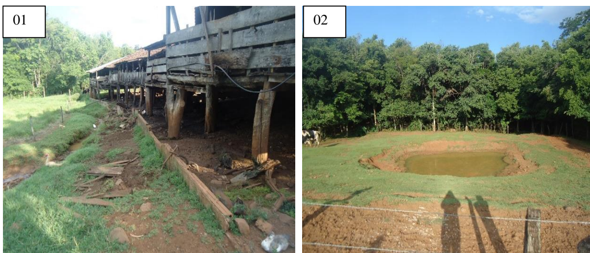
IMAGEM 07: Estabelecimento rural de suinocultura desativado. Fotos 01: muro de contenção na granja desativada; Fotos 02: lagoa de tratamento de chorume desativada.
