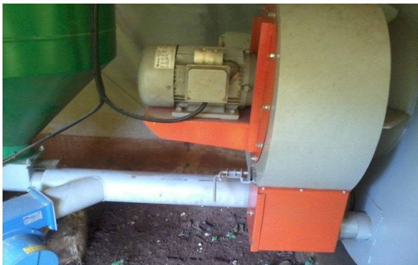
Foto 8: Silo, motor e elicóide da máquina que queima o pellets
