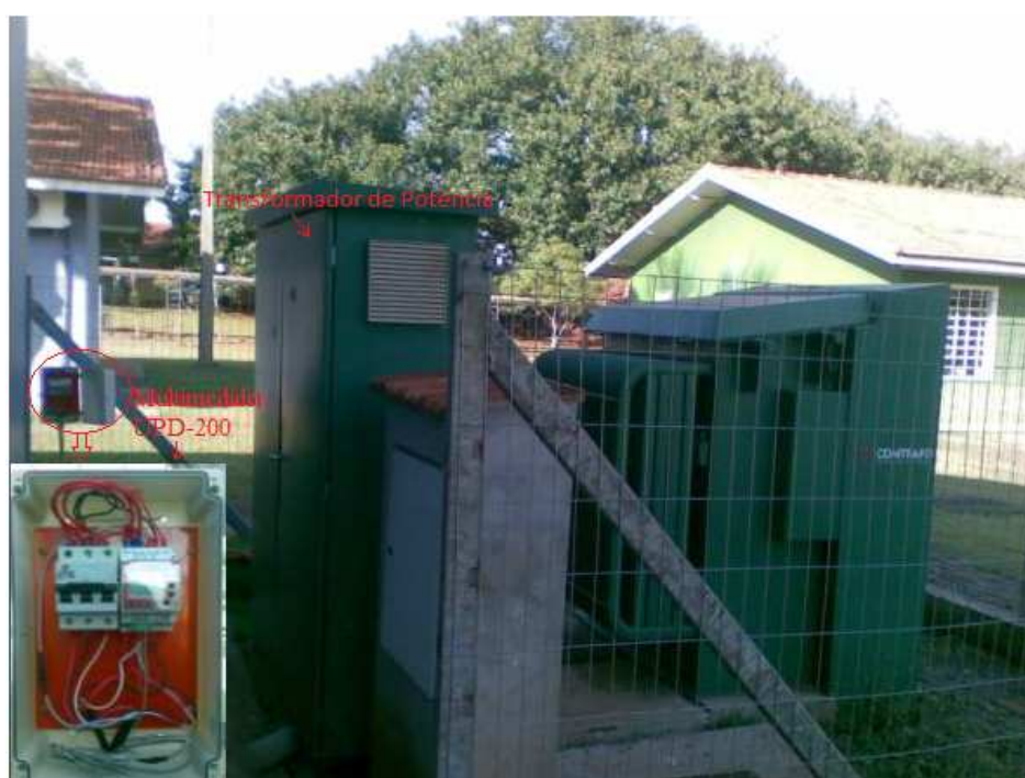
Figura 4.9: Multimetro UPD-200 instalado em um transformador do PTI.
